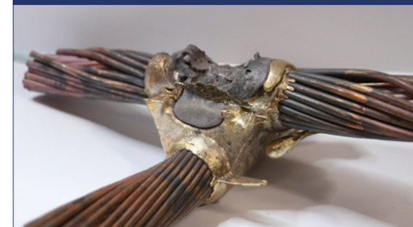
SOLDADURA NO ACEPTABLE
